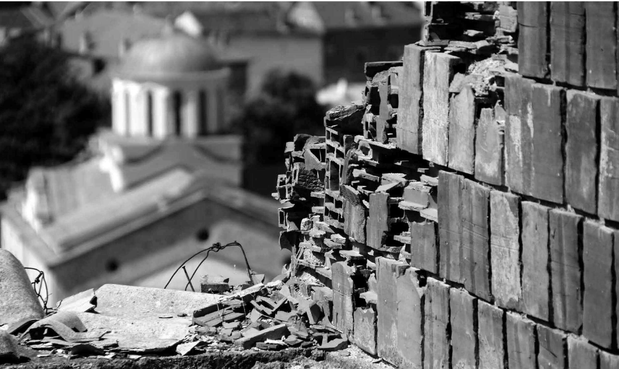
Im März 2004 wurden von Serben bewohnte Häuser im Quartier Podkalja von Prizren von albanischen Nationalisten niedergebrannt. Internationale Hilfswerke aus Dänemark und Grossbritannien bauen zurzeit zehn zerstörte Häuser neu auf und wollen einige der vertriebenen Serben zur Rückkehr bewegen. Im Hintergrund ist die wieder aufgebaute serbisch-orthodoxe Kirche St. Georg zu sehen. Die Sinan-Pascha-Moschee in Prizren besitzt das höchste Minarett des Balkans. Sie wurde Anfang des 17. Jahrhunderts erbaut. Die farbenprächtigen Kuppelmalereien wurden kürzlich mit Hilfe türkischer Gelder renoviert und vor dem Ramadan dieses Jahres eingeweiht (rechts oben).
